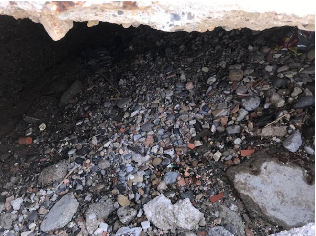
Photo 2 : Affouillement sous la dalle
